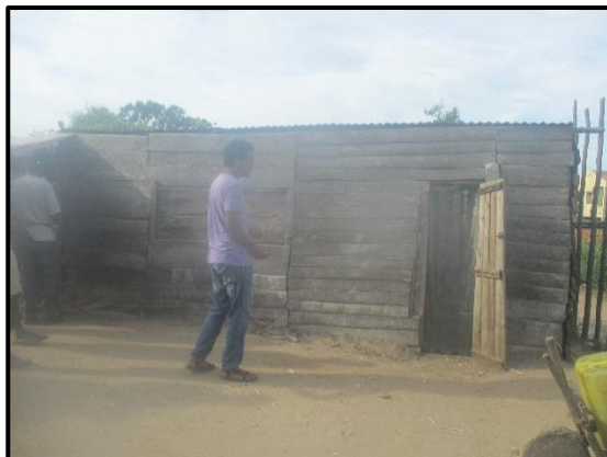
Photo 15 : Mur en bois, sol nu, toiture en tôle
