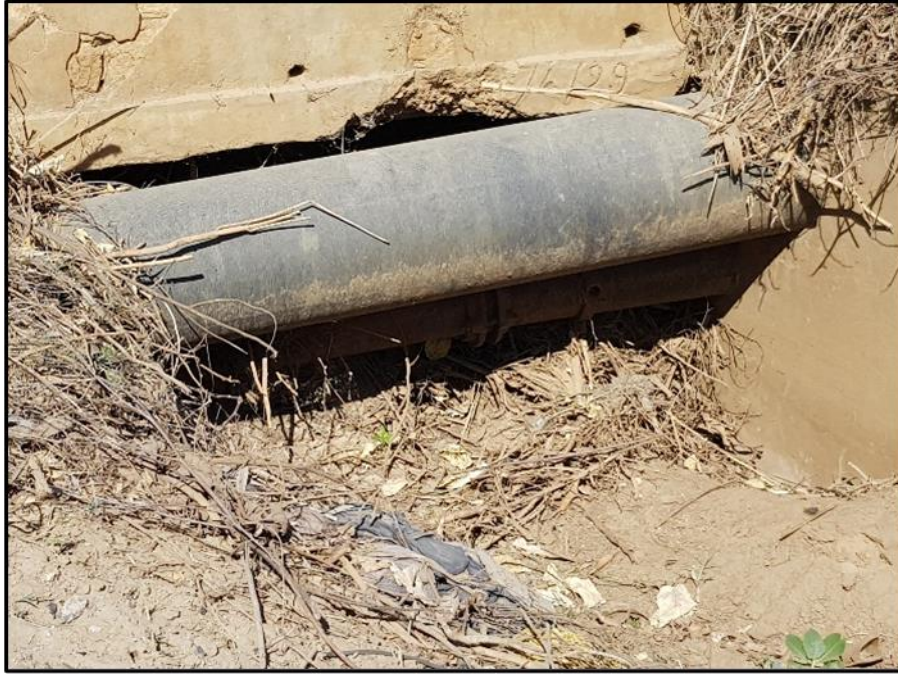
PHOTO 13 : CONDUITE D'EAU POTABLE VERS MIARY
