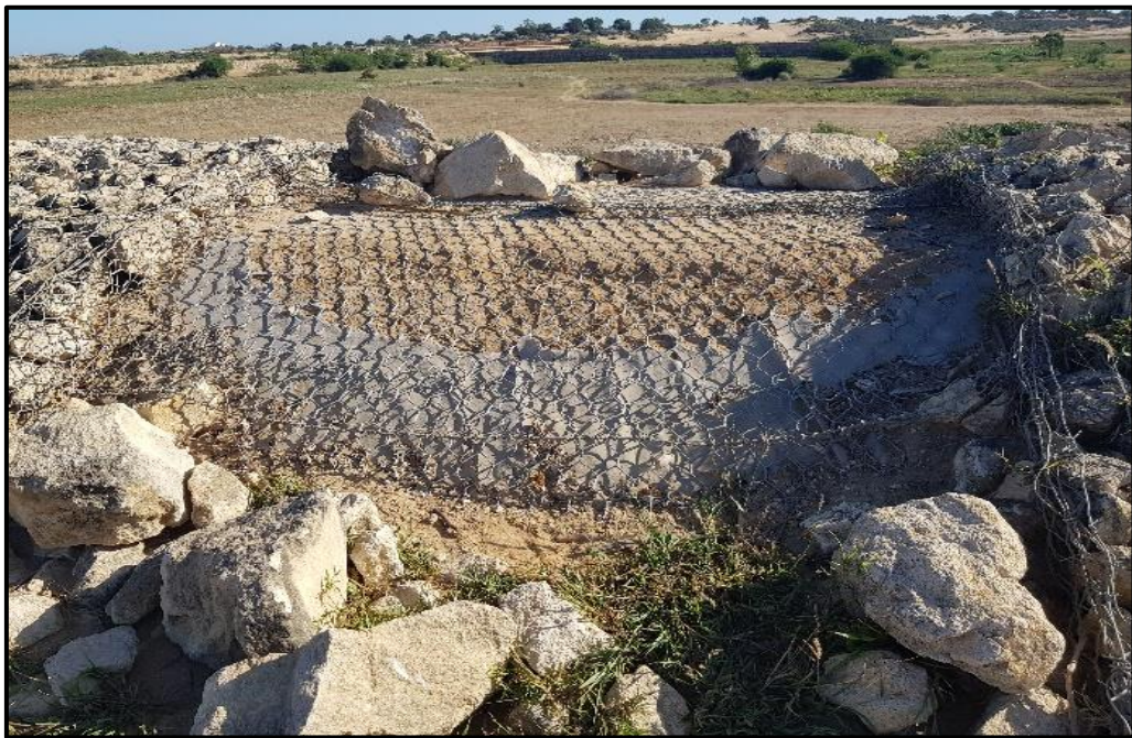
PHOTO 8 : PARTIE VANDALISÉE DU MATELAS DE GABION
