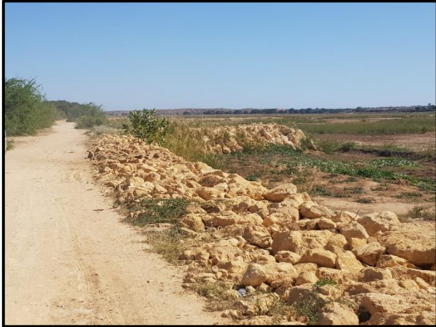
PHOTO 9 : DIGUE NON PROTÉGÉE PAR MATELAS DE GABIONS
