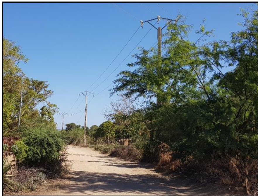
PHOTO 14 : LIGNES ÉLECTRIQUES DE MOYENNE TENSION À PROXIMITÉ DE MIARY
