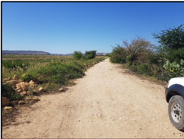
PHOTO 11 : BRÈCHE DANS LA DIGUE (À GAUCHE)
