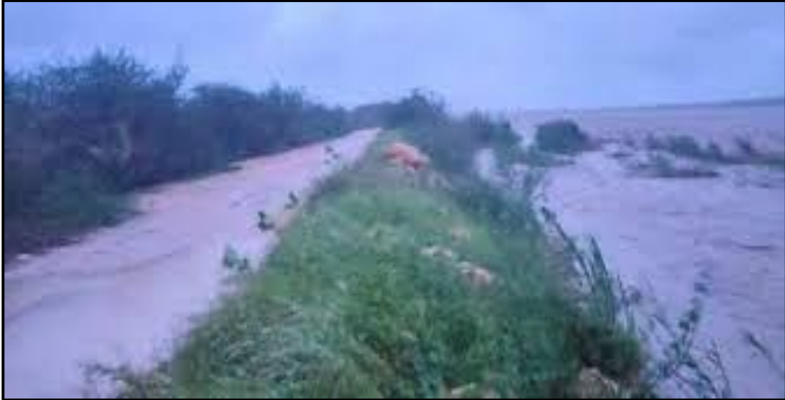
Photo 8 : Menace d'inondation sur la digue de Fiherenana lors du cyclone Freddy en mars 2023
