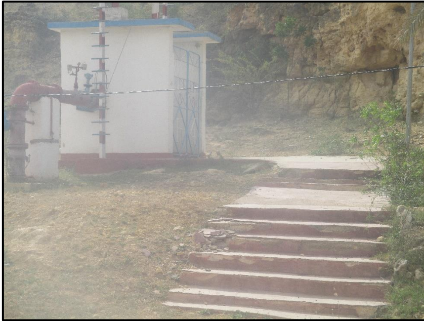
Photo 7 : Station de pompage à Miary
